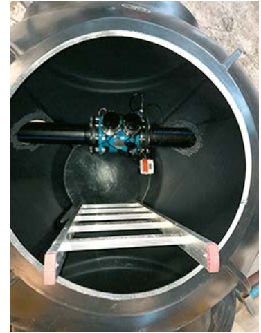
Mittakaivoon asennettu magneettis-induktiivinen virtausmittari.
