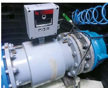
Etäluentaan kytketty virtausmittari.
